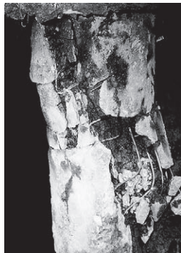
杭頭を剛接した杭の被害例
